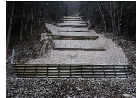
間伐材を活用した木製校倉式土留工
