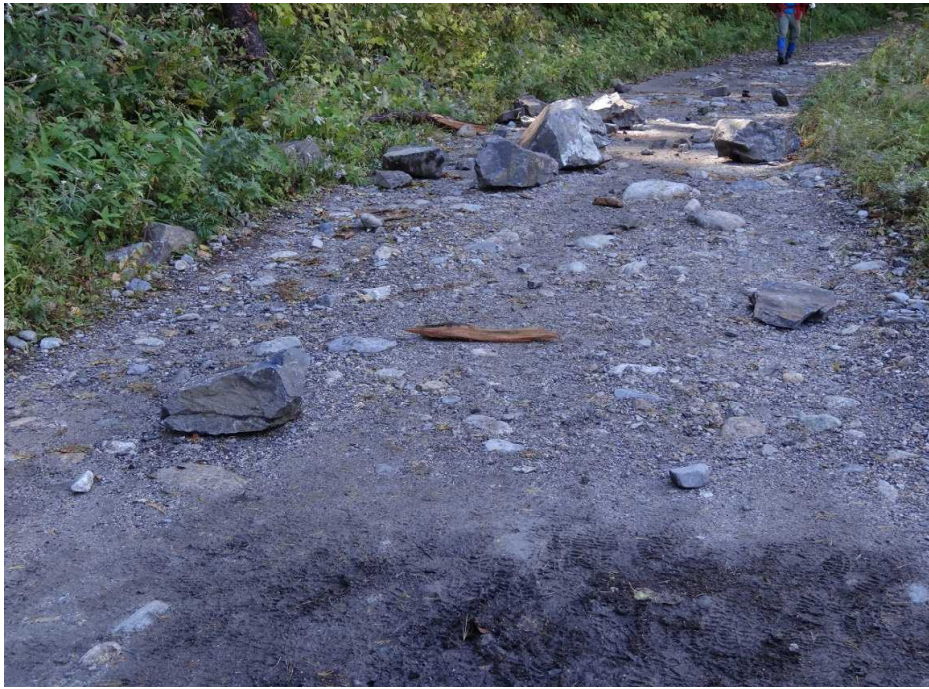
10月2日 落石有り、歩道脇へ寄せて処理しました。
