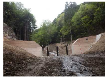
スリット谷止工による流木対策
